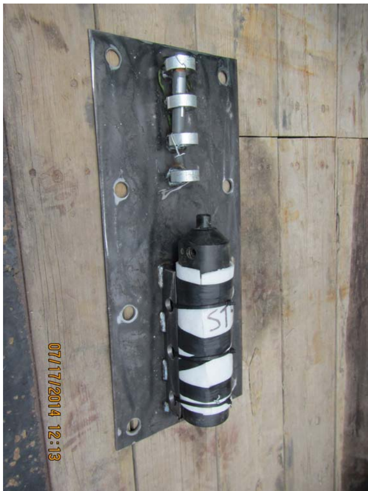
PHOTOS 11 et 12 — Installation des récepteurs télémétriques fixés aux quais du port de Québec en 2014
