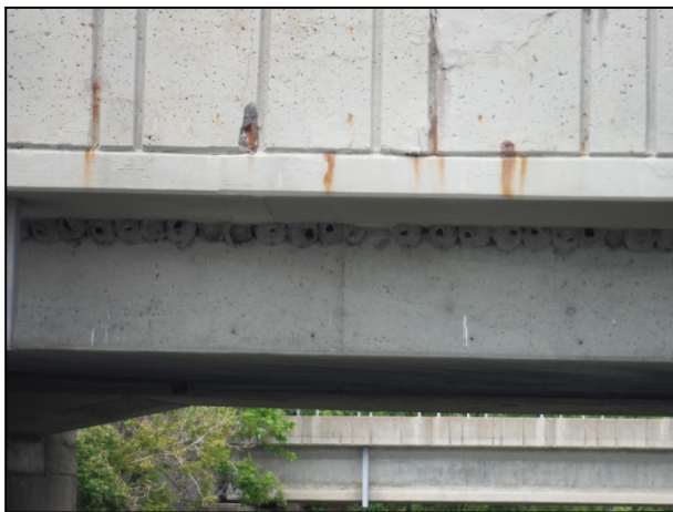
Photo 1 (F1016 du CD) Nids d'hirondelle à front blanc – pont de la rivière Beauport
